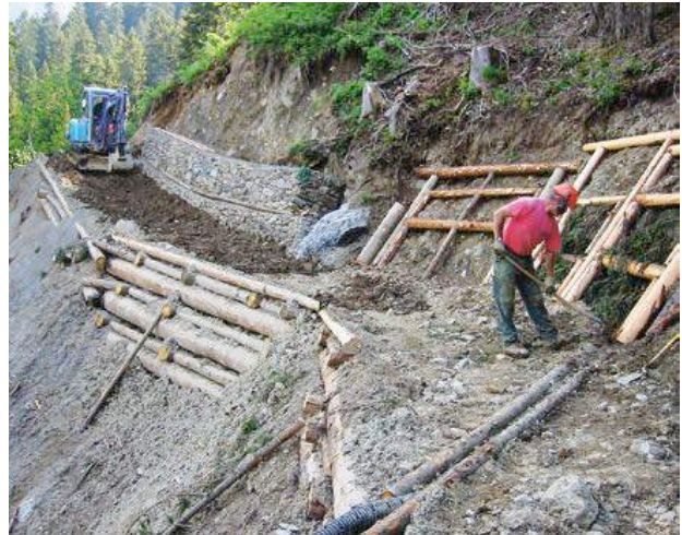
Exemple de caisson en bois à l'aval et de treillage à l'amont du chemin (source: OFROU, SuisseRando, Manuel)
